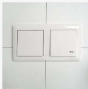
Lichtschakelaar en stopcontact
