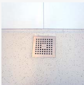
Anti-slip vloer met afvoer
